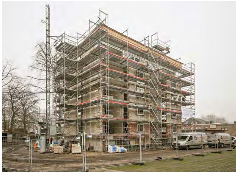
Durch eine Bestandsanalyse wurde am Gebäude im Akazienweg ein deutlicher Sanierungsbedarf erkannt, worauf eine Kernsanierung folgte. Nun sollen ähnliche Sanierungsschritte bei allen Gebäuden folgen
